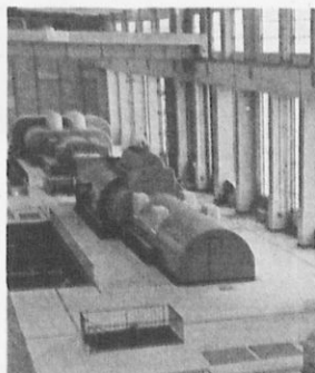
Σχ. 1. Ηλεκτρογεννήτριες του άτμοηλεκτρικού σταθμού Πτολεμαΐδας
