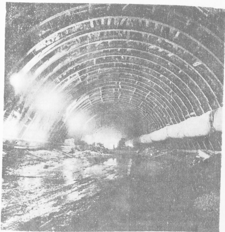
Εικ. 158. Μία άποψις τής μεγάλης σήραγγος (μήκους 808 μ. και πλάτους 12,60 μ.), δια τής οποίας έχει γίνει έκτροπή τών υδάτων του ποταμού Άχελώου δια να κατασκευασθῆ εἰς τήν καθορισθεῖσαν θέσιν τὸ μεγάλο χωμάτινον φράγμα. Τοῦτο ἔχει ὕψος 153 μ. καὶ θ' εἶναι τὸ ὑψηλότερον φράγμα εἰς δλόκληρον τήν Εὐρώπην. Ἡ τεχνητὴ λίμνη, πού ἐδημιουργήθη, θὰ εἶναι 110 φορές μεγαλύτερα ἀπὸ τήν λίμνην τοῦ Μαραθῶνος. Προβλέπεται ἐδῶ ἡ κατασκευὴ τριῶν ὕδροηλεκτρικῶν ἐργοστασίων, μετὰ τὰ ὁποῖα ἡ συνολικὴ παραγωγή ἡλεκτρικῆς ἐνεργείας τῆς χώρας μας θὰ ὑπερδιπλασιασθῆ.
