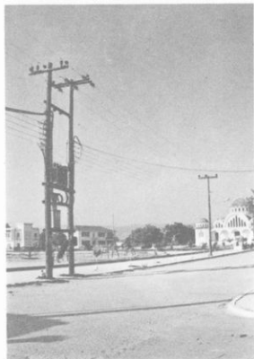
Σχ. 3. Μετασχηματιστής χαμηλής τάσεως. Μετατρέπει τά 15.000 V σε 220 V και τροφοδοτεί το Στεφανοβίκειο Βόλου
